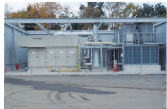
ガスコージェネレーション
