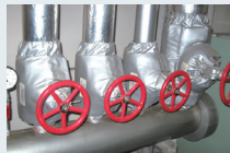
蒸気配管の断熱
