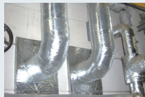
配管保温の強化
