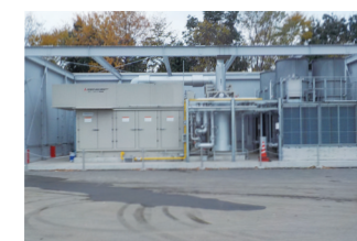
ガスコージェネレーション
