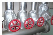
蒸気配管の断熱
