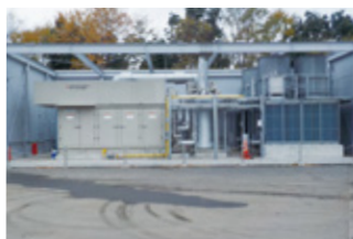
ガスコージェネレーションシステム
